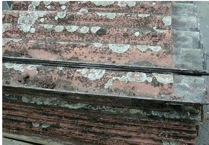
Figuur 8: asbesthoudende golfplaten
